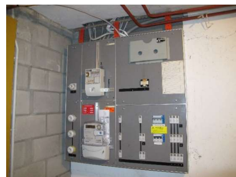
Immagine 13 Quadro elettrico
