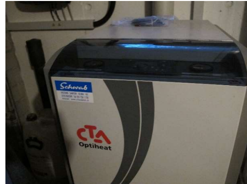
Immagine 7 Pompa di calore
