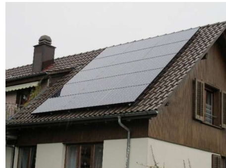
Immagine 12 Impianto fotovoltaico
